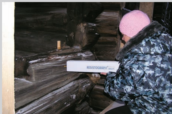
Оценка состояния древесины
