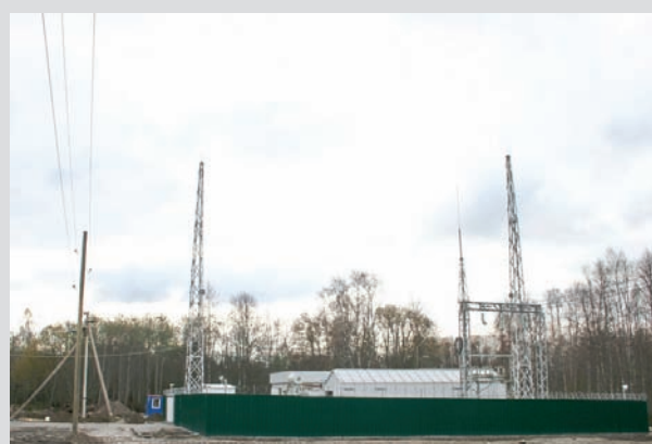
Трансформаторная подстанция «Жарниково»
