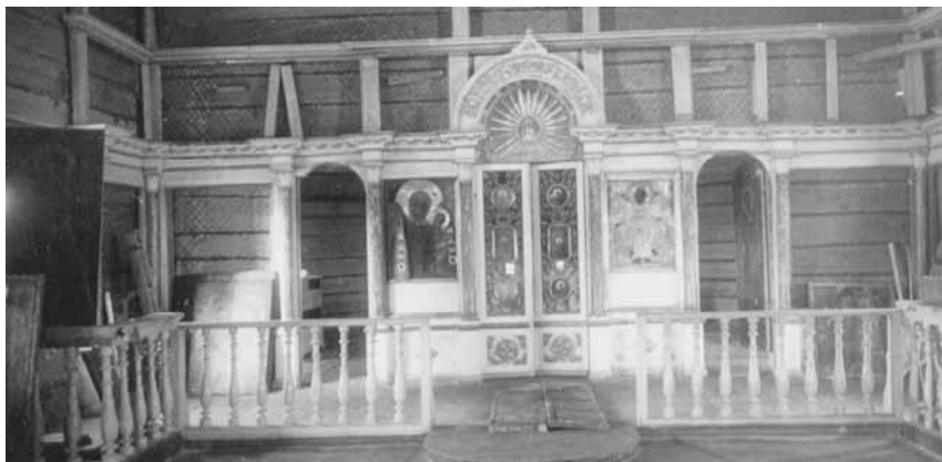
Иконостас Покровской церкви. Вид полуразрушенной столярной рамы. Фотография
