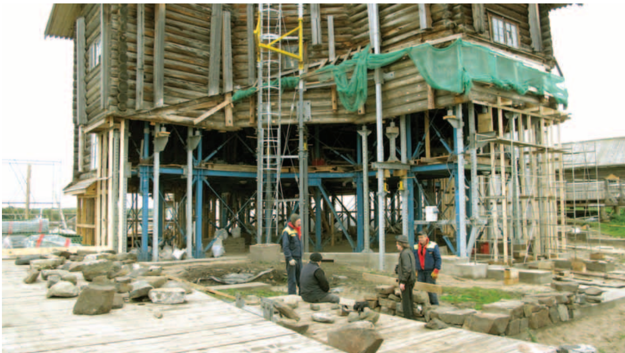
фото 3. Закончено бетонирование фундамента и выложен экспериментальный участок кладки, закончен демонтаж бревен Преображенской церкви
