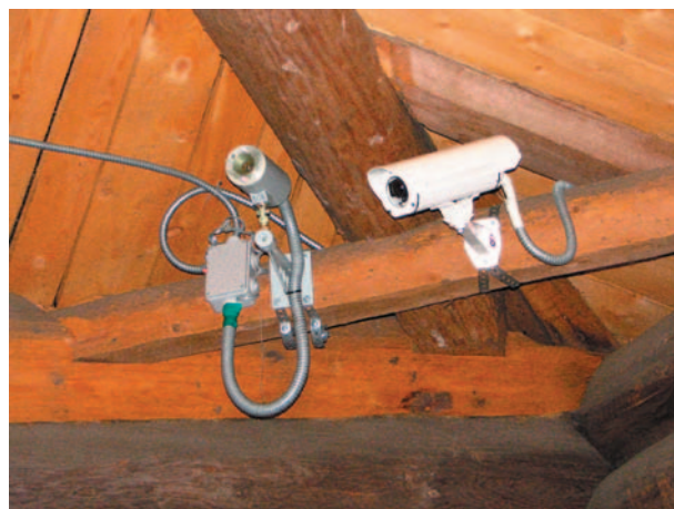
рис. 38. Видеокамеры охранно-пожарной сигнализации в здании Преображенской церкви
