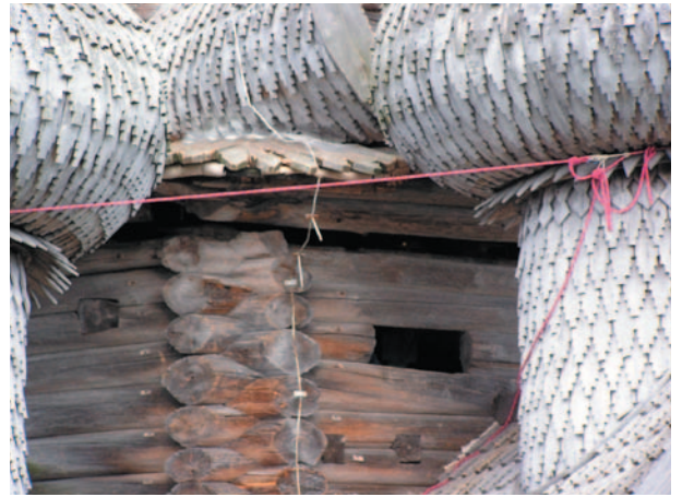
рис. 30. "Отрыв" конструкций, вид снаружи памятника
