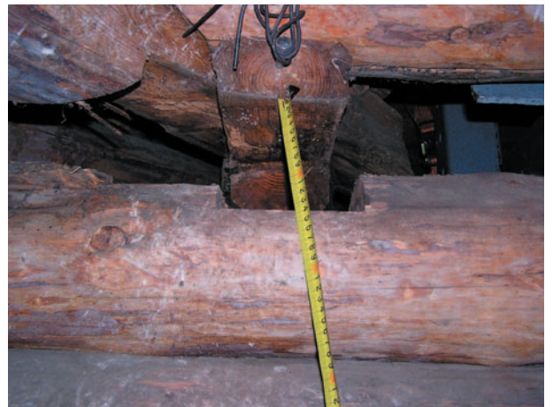
рис. 31. "Отрыв" конструкций, вид изнутри памятника
