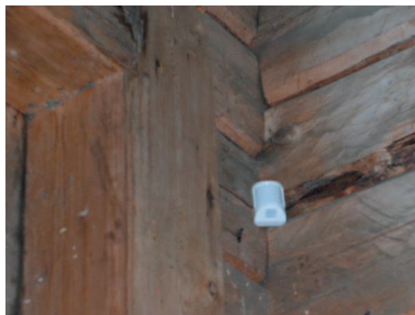
рис. 37. Датчик охранно-пожарной сигнализации в здании Покровской церкви
