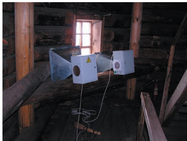
рис. 57. Микроволновые “пушки” работают на объектах музея-заповедника “Кижы”
