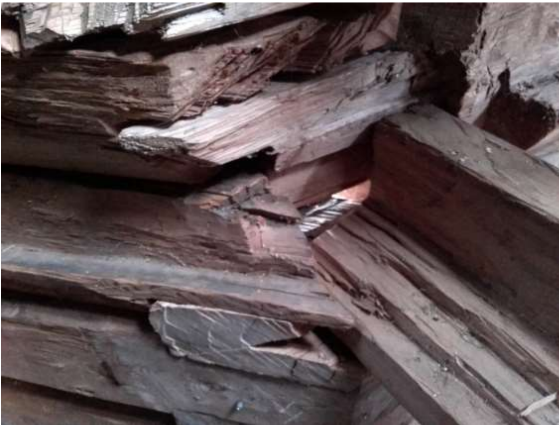
Опорное кольцо потолка «небо». Соединения балок по верху прирубов сломаны и утратили свою функциональность. Шуруп в нижней части бревна является точкой для мониторинга.
